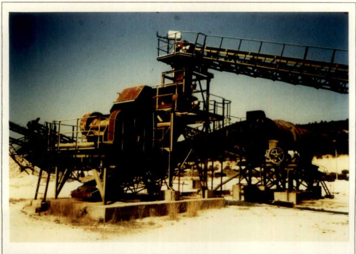
Fotografía-3: Detalle de la planta de tratamiento
